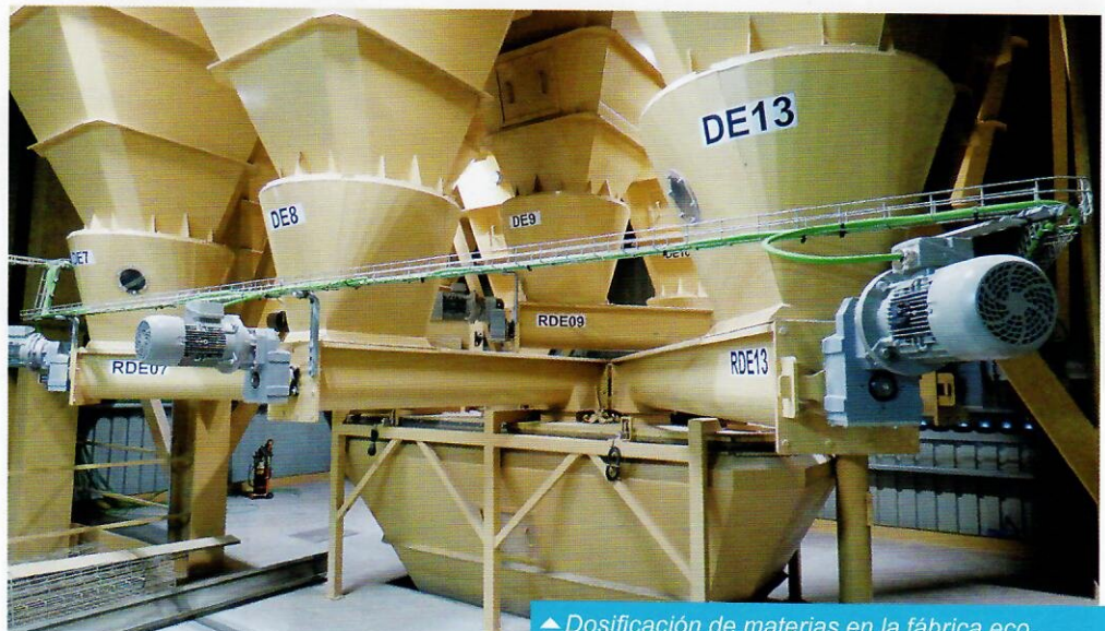
▲ Dosificación de materias en la fábrica eco, en Campoastur.
